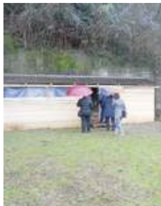
Il rifugio danneggiato
