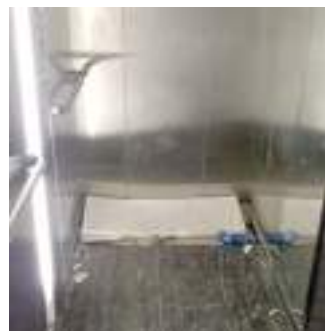
L'ascensore con i calcinacci
